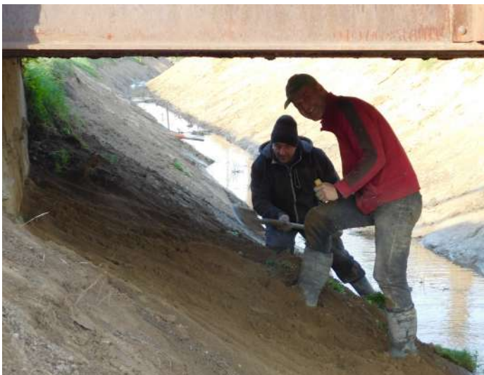
Schlammabeseitigung unter einer Brücke
